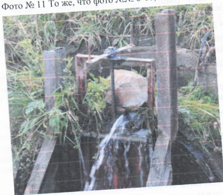
Фото №12 Состояние заслонки;
